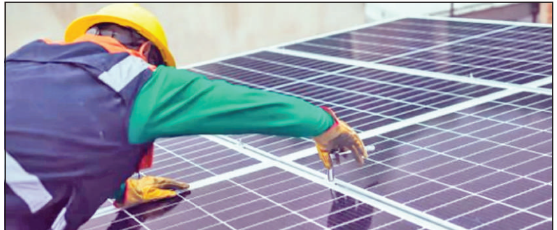
Painéis solares para geração de energia solar fotovoltaica
